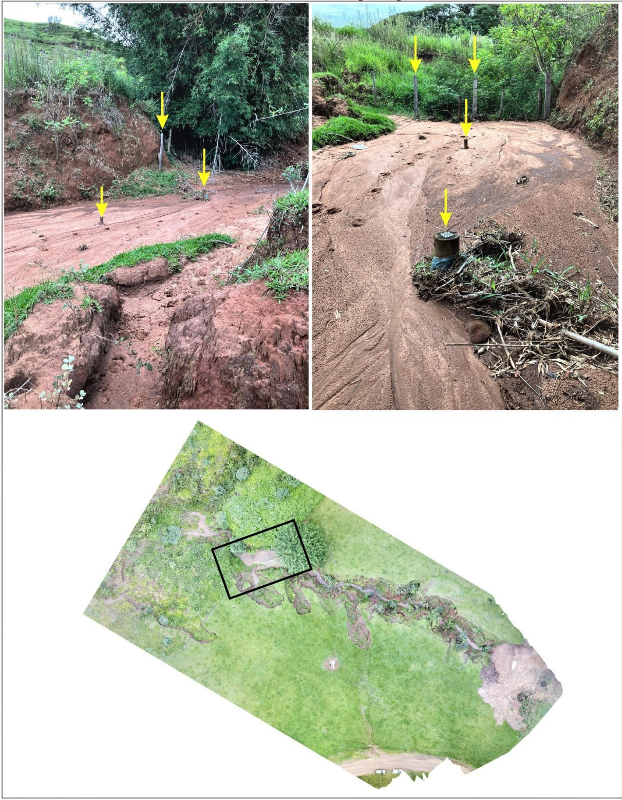
Figura 7 - Sinais de assoreamento no canal que drena a voçoroca estudada entre a ramificação 1 e o eixo principal
