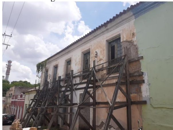
Figura 1 - Edifício degradado escorado em estruturas de madeira
