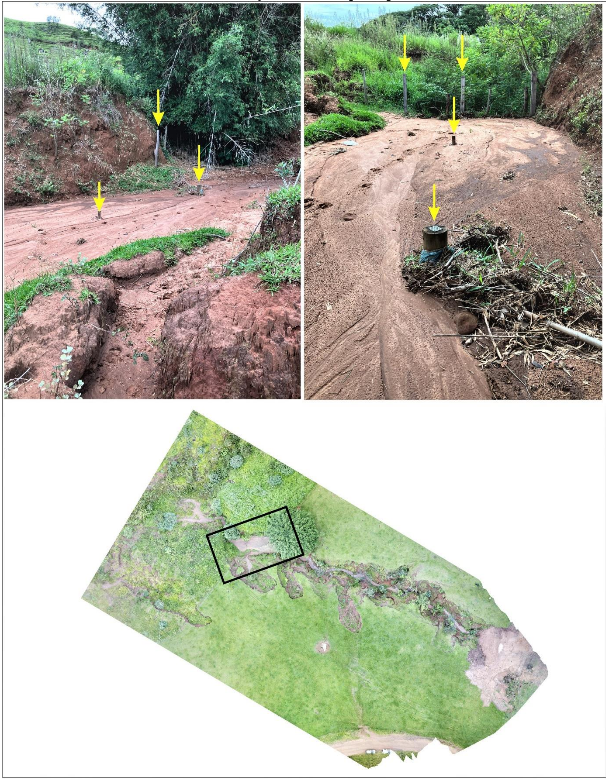
Figura 7 - Sinais de assoreamento no canal que drena a voçoroca estudada entre a ramificação 1 e o eixo principal
