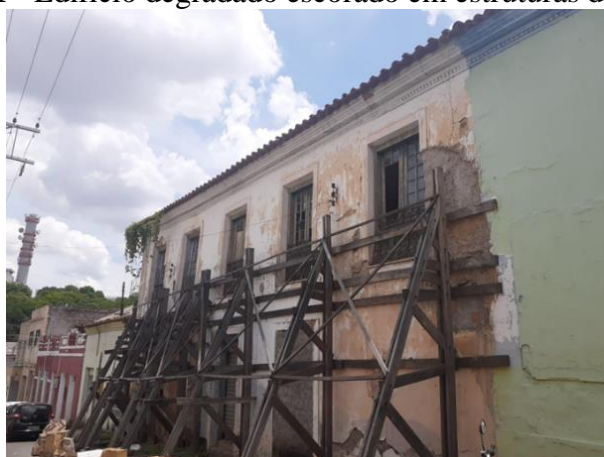
Figura 1 - Edifício degradado escorado em estruturas de madeira
